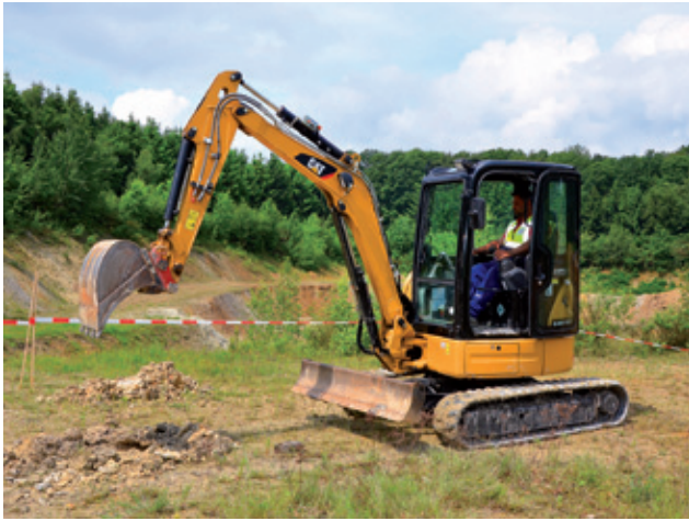
Auch kleine Geräte reichen für eine Tümpelanlage aus.
